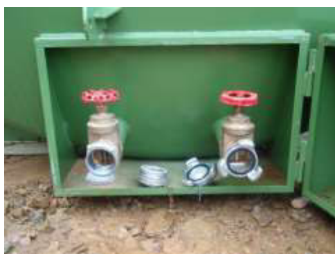
Exemple de création de point d'eau transfrontalier présentant des raccords français et Catalans (Point d'eau n°370 depuis piste AL17, Commune de Le Perthus)
