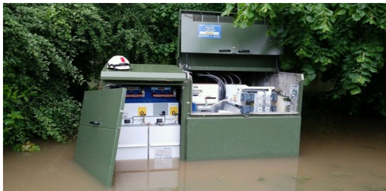
Poste d'électricité en zone inondée
